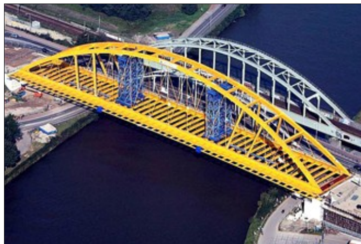
Figure 1: pont Hogeweide de près de 3.000 tonnes à Utrecht réalisé par Victor Buyck Steel Construction nv
